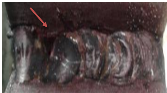
Figura 4-3: Discontinuidad en el cordón de soldadura E01.2
