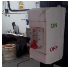
Figura 19-4: Activación de breakers
