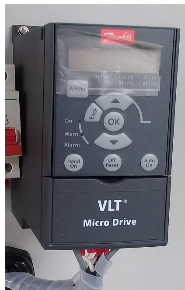
Figura 3-1 Variador de frecuencia
