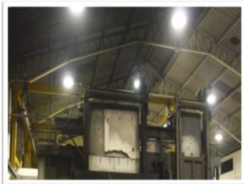
Figura 68. Iluminación del Área de Fundición (actual).
