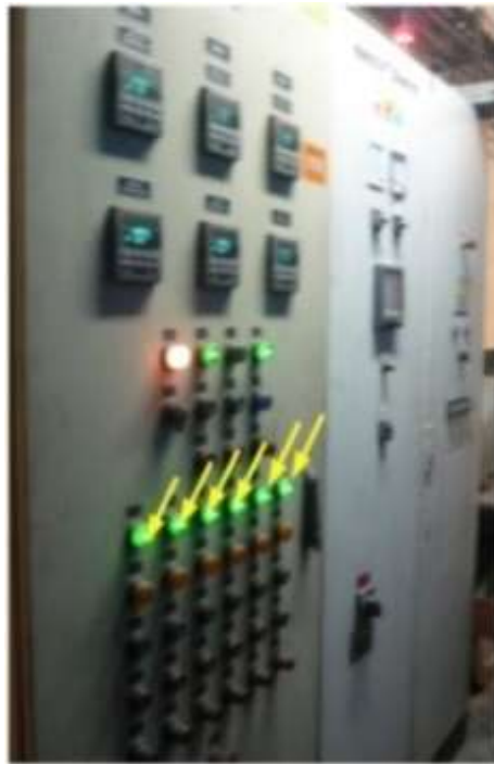
Figura 44. Tablero de Control del Horno.
