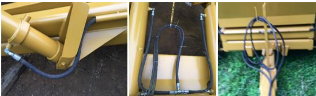
Figura 5-6: Mangueras instaladas del elevador hidráulico
