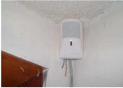
Figura V.78 Ubicación del sensor PIR
