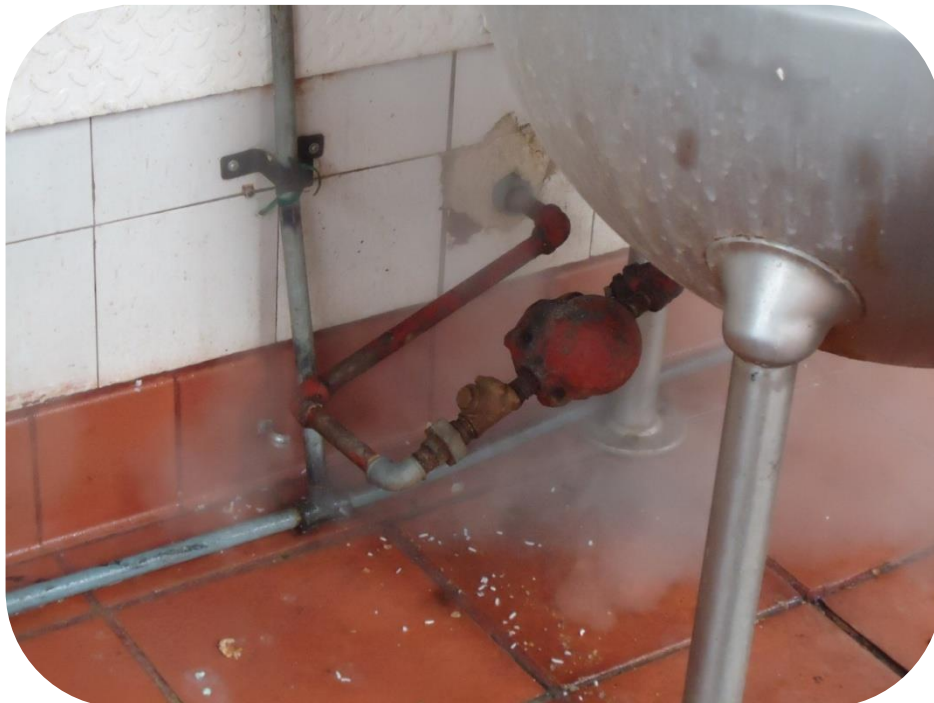
Fugas en ductos de vapor
