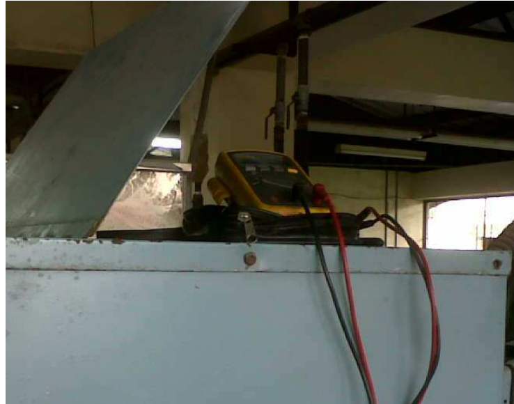
Figura III.30 Prueba con multímetro
