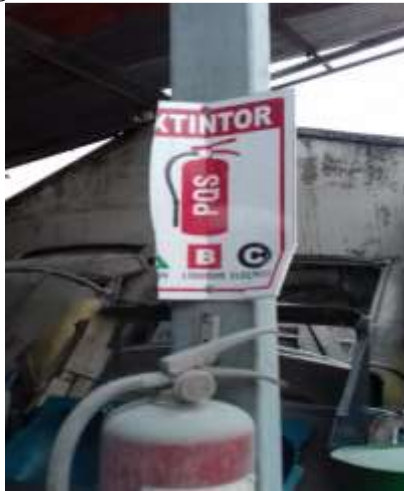
Figura 21-3. Señalética en mal estado
