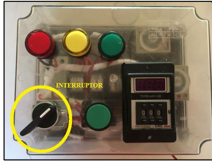
Figura 16-5. Ubicación del interruptor
