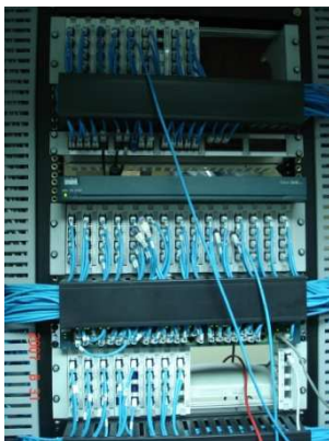
Figura III.7 Equipos de interconectividad en el Edificio Villafuerte - Cuarto de Servidores.
