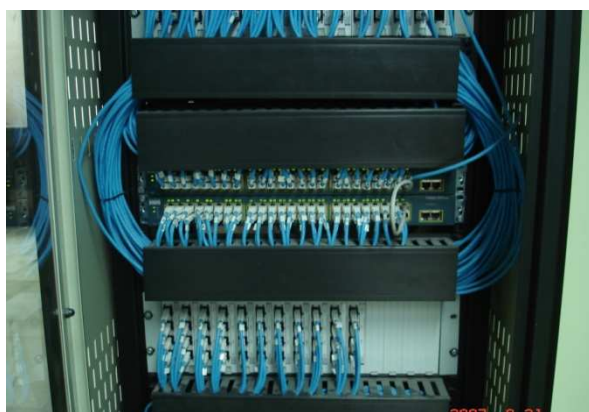
Figura III.6 Equipos de interconectividad en el Edificio Villafuerte - Mezanine.
