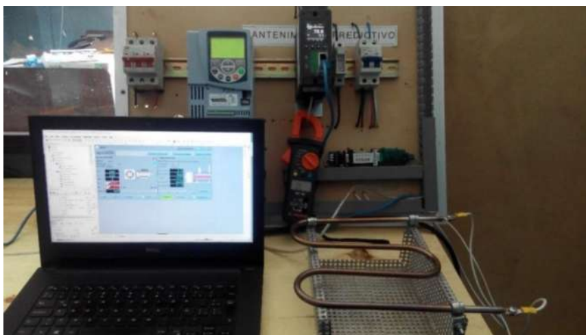
Figura 32-2 Toma de medidas de corriente con un Multímetro Truper, en una carga resistiva con referencia a el sistema Scada y el dispositivo Epac-1PH. Realizado por: Edwin Herrera, 2018.
