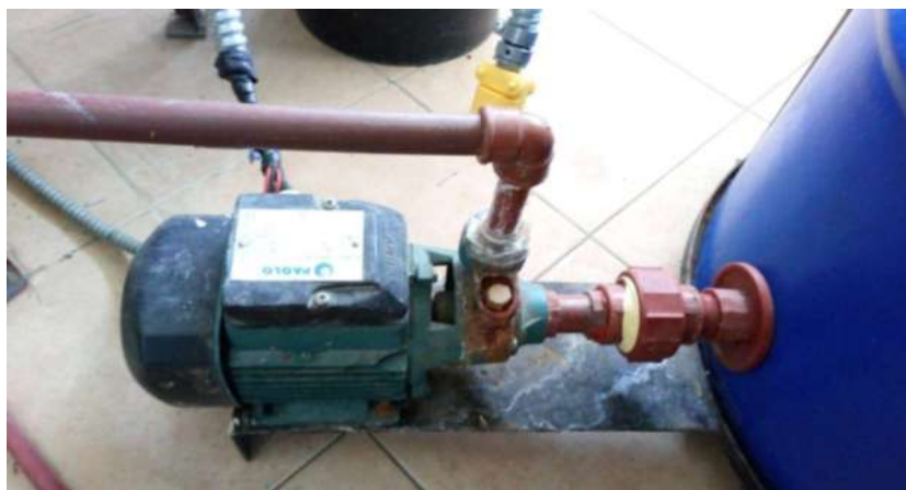
Figura 8-2: Bomba PAOLO conectada al contenedor de agua.
