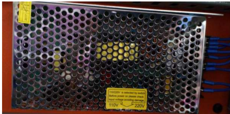
Figura 6-2: Fuente de poder ubicada en el interior del tablero del control.
