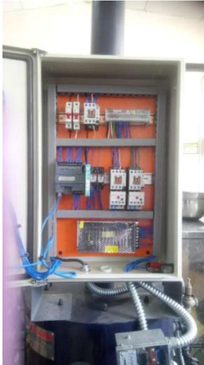
Figura 35-2: Parte interior del tablero de control.
