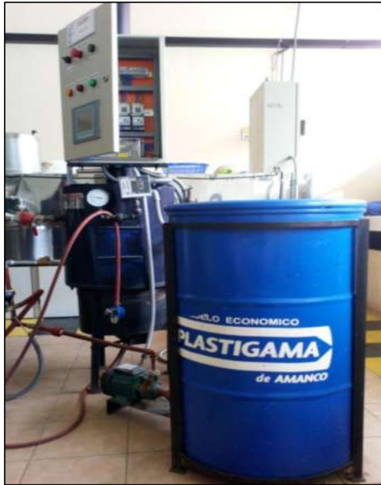
Figura 37-2: Sistema de control instalado del caldero.
