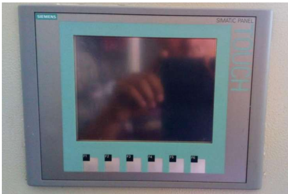
Figura 3-2: Touch Panel KTP600 instalado en el tablero de control.
