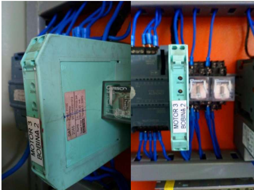
Figura 13-2: Transmisor DAT2065 instalado.
