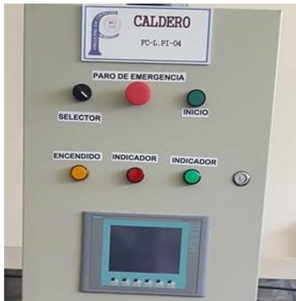
Figura 36-2: Parte Frontal del tablero de control.
