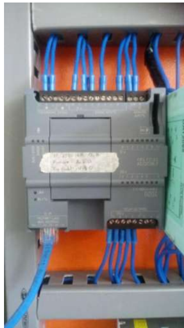
Figura 2-2: PLC S7-1200 instalado en la parte interior del tablero de control.
