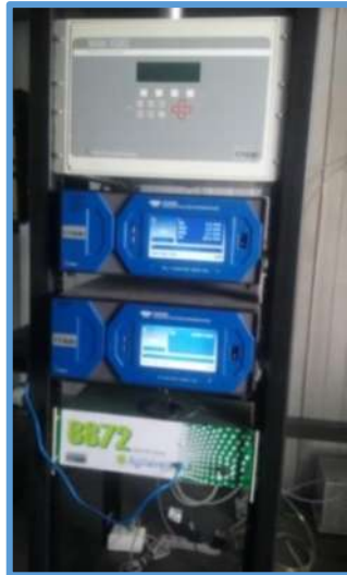
Figura 17-3: Analizadores de gases GADMA
