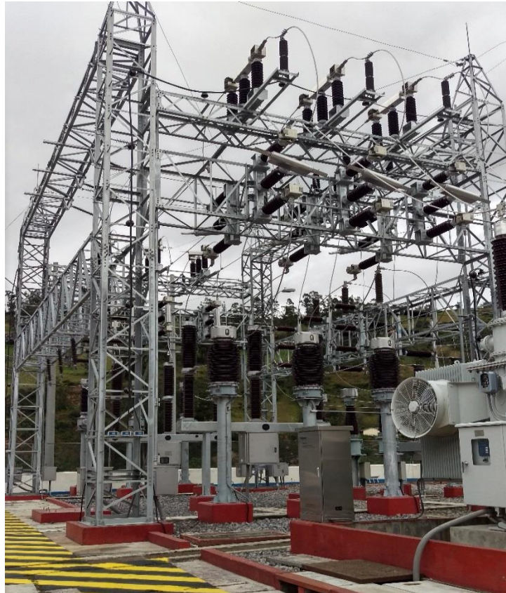
Figura 3-1. Subestación Guaranda actualmente en operación
