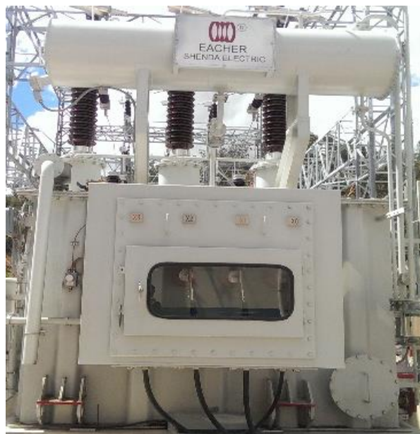
Figura 5-1. Transformador de Potencia actualmente en funcionamiento S/E Guaranda
