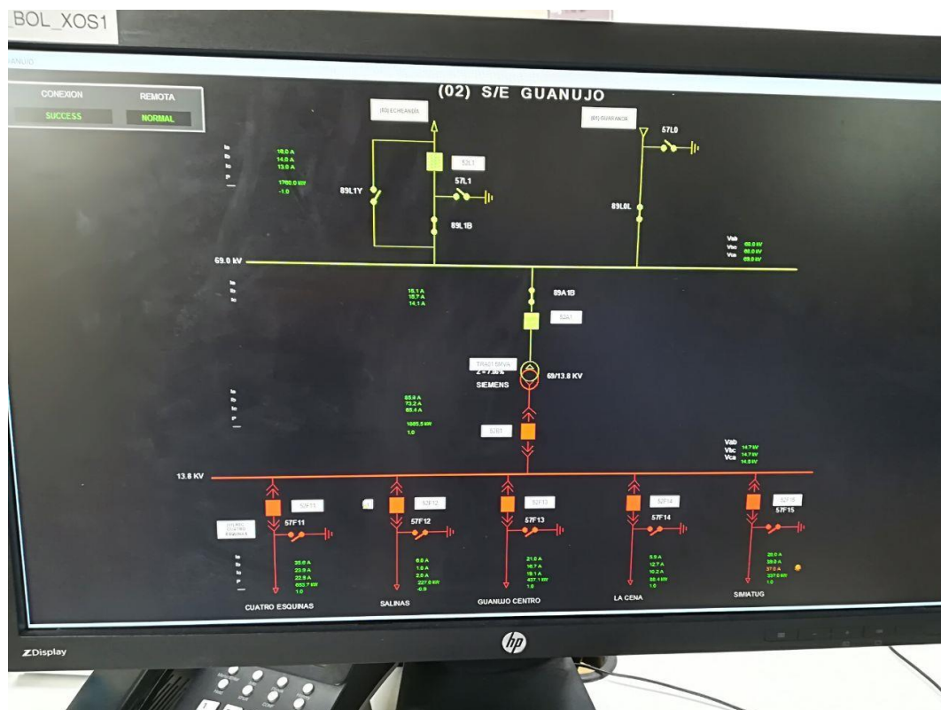
Figura 34-2. Sistema Scada Guanujo
