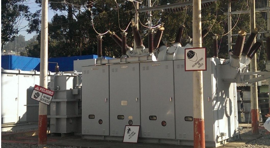
Figura 2-2. Transformador de Potencia de 5MVA, SE Guaranda
