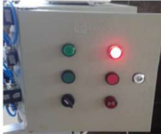
Figura 1: Tablero de control
