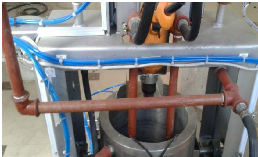
Figura 24-3: Entrada de la red de agua potable al Sistema automatizado.
