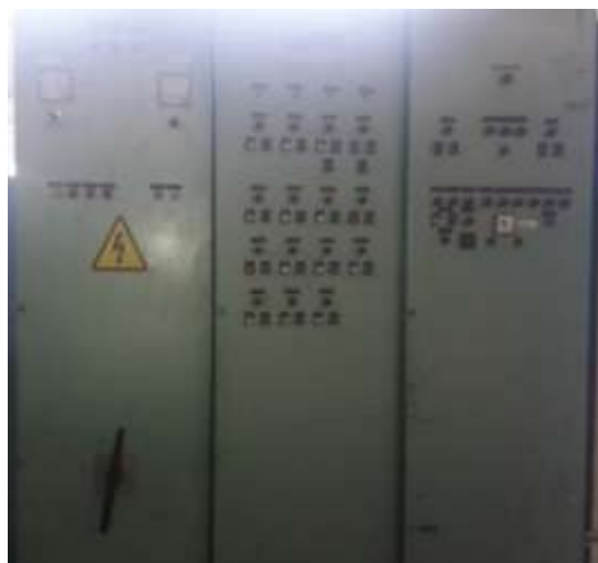
Figura 15-1 Tablero de alimentación general
