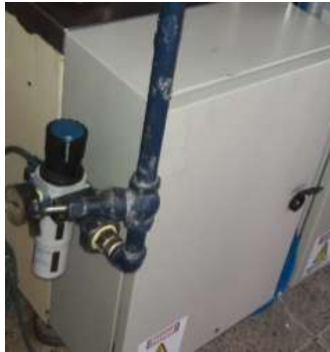
Figura 24-2 Tablero del sistema neumático
