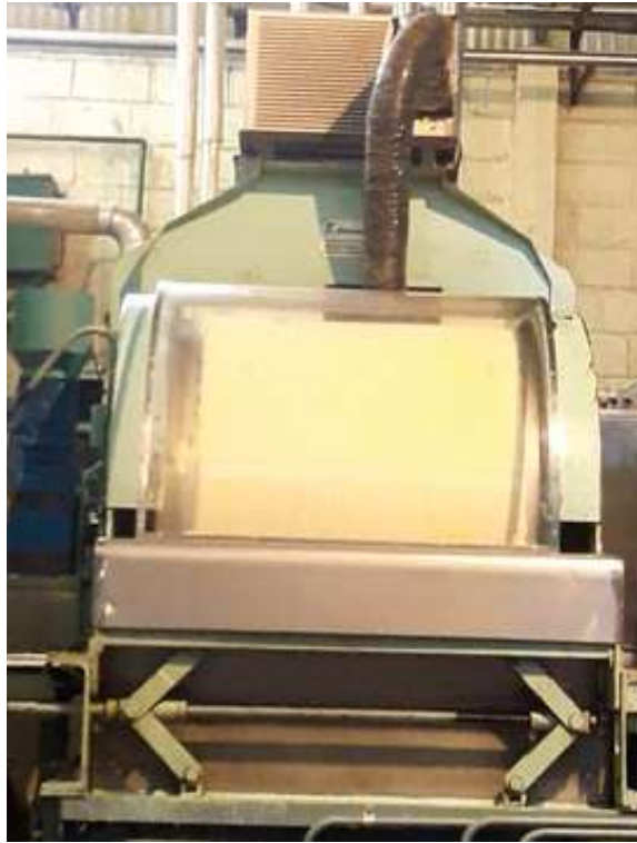
Figura 1-1 Filtración del RBD en área de fraccionamiento
