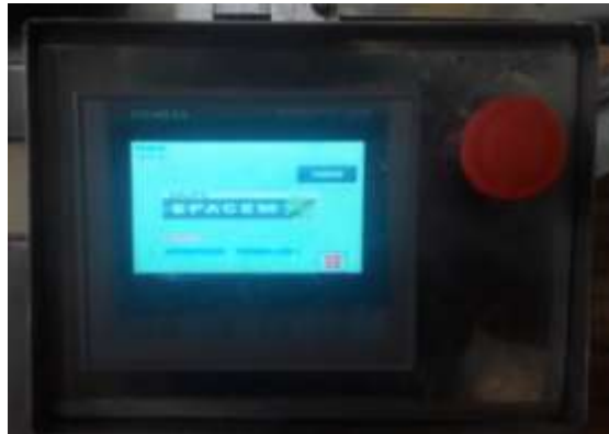
Figura 27-2 Instalación de pantalla HMI
