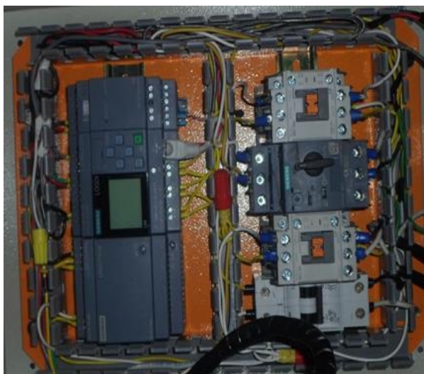
Figura 13 - 2 Cableado de los dispositivos Realizado por: VELASCO, Deicy, 2017
