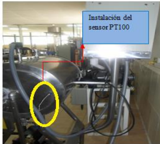
Figura 17 - 2 Implementación del Sensor PT100 Realizado por: VELASCO, Deicy, 2017
