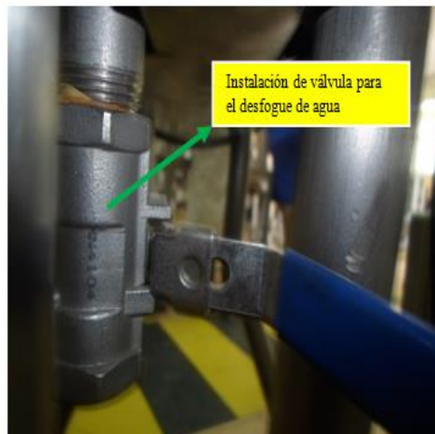
Figura 9 - 2 Llave para el desfogue de agua Realizado por: VELASCO, Deicy, 2017
