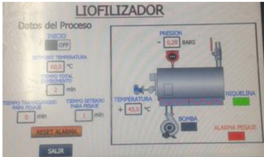
Figura 36 - 2 Pantalla de activación de la alarma Realizado por: VELASCO, Deicy, 2017
