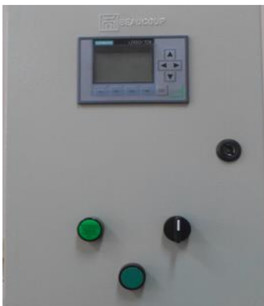
Figura 14 - 2 Colocación de pantalla HMI, pulsador, luz y selector Realizado por: VELASCO, Deicy, 2017
