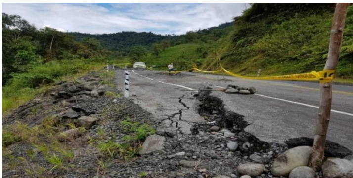
Fotografía 9: Hundimiento de mayor magnitud.
