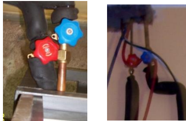
Figura 4.12 Detalles de la ubicación de la válvulas de paso.
