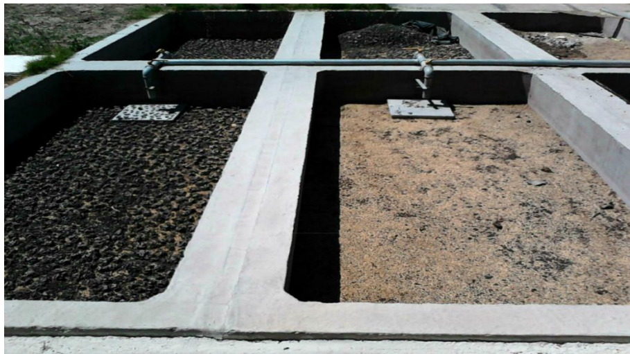
Figura 13-3 Lecho de secado de lodos
