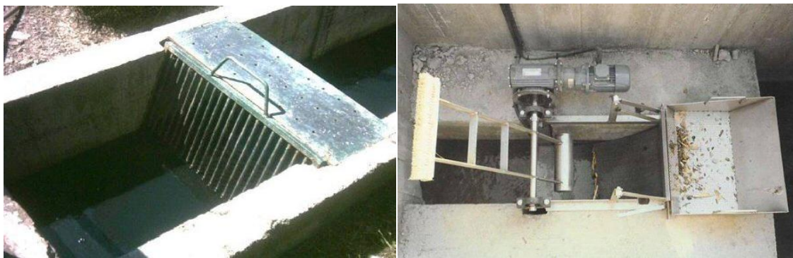
Figura 6-3 Rejillas de limpieza manual y limpieza mecánica Realizado por. Christian Córdova 2018
