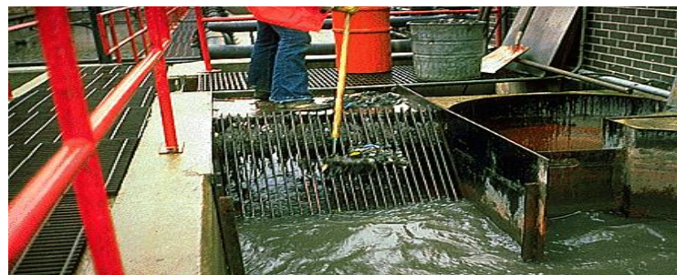
Figura 4-3 Rejillas de limpieza manual
