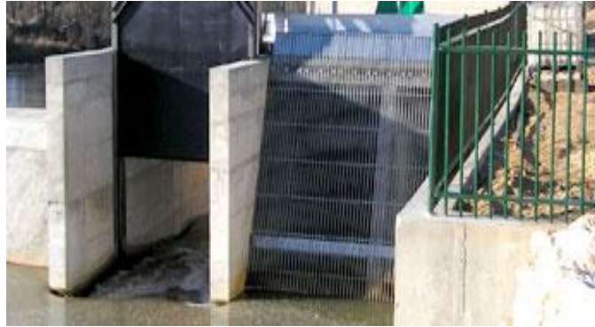
Figura 3-3 Sistema de desbaste en una PTAR
