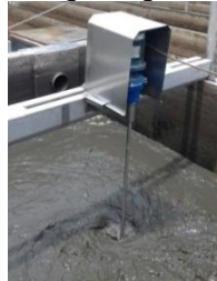
Figura 15-3. Tanque equalizador y mixer.
