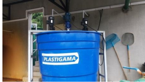
Figura 22-3. Tanques dosificadores de 500 lts.
