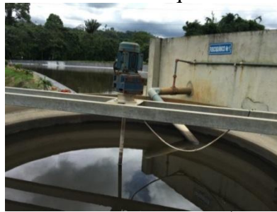
Figura 23-3. Mixer de los tanques de físico-químico.
