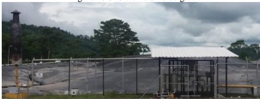
Figura 20-3. Sistema Skid de gas.
