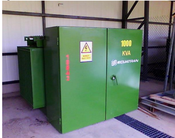
Figura 27-3. Transformador de media tensión.
