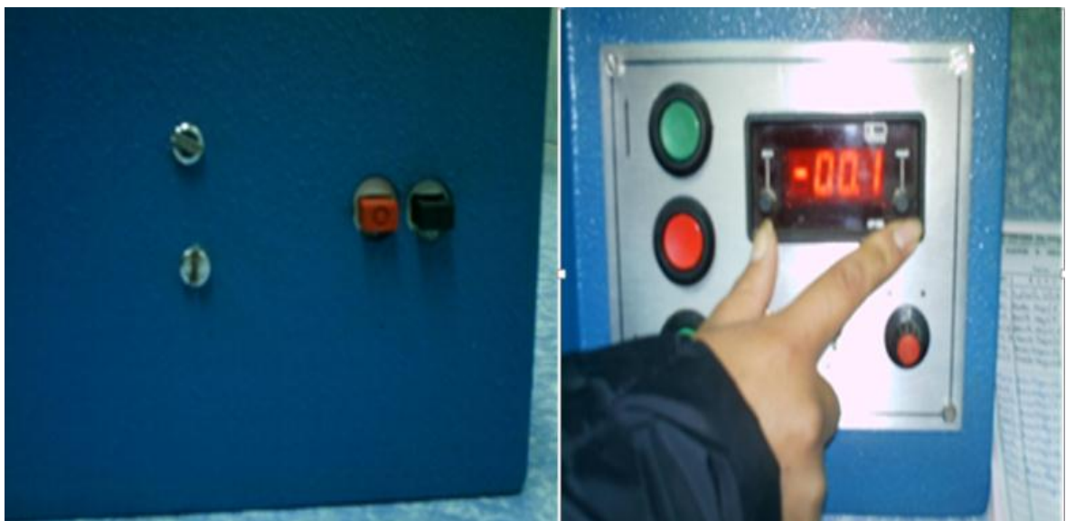
Fotografía 5. Encendido del equipo.
