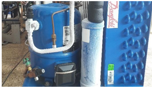
Figura 8-3: Congelamiento en el conducto de baja de la unidad condensadora
