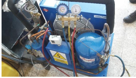
Figura 6-3: Aparición de escarcha en tubería que va al compresor
