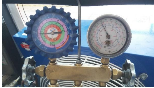
Figura 4-3: Toma de datos de presiones de funcionamiento del compresor.
