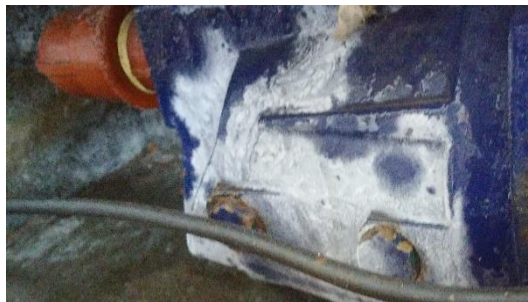
Figura 9-3: Congelamiento en la bomba
