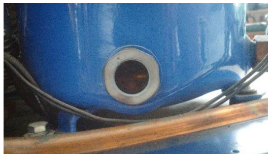
Figura 2-3: Mirilla para comprobar el nivel de aceite en el compresor
