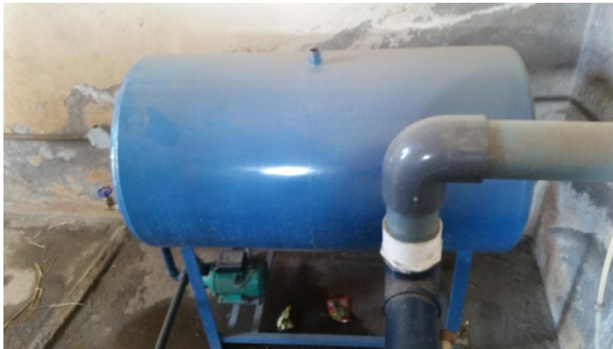
Figura 5-2. Tanque de almacenamiento de agua y condensado existente
