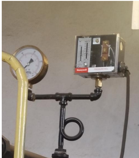
Figura 12-2. Presóstato cola de cerdo existente
