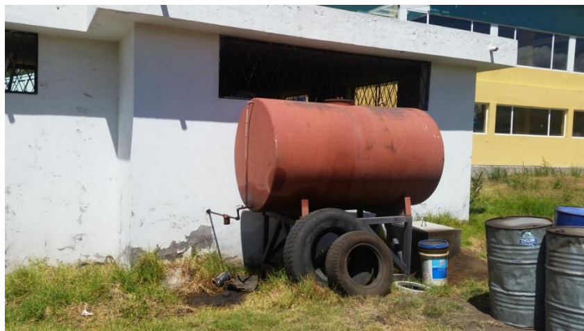
Figura 16-2. Tanque de almacenamiento de combustible Fuente: Autor
