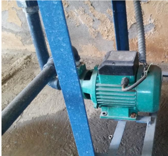
Figura 6-2. Bomba de agua centrifuga existente Fuente: Autor
