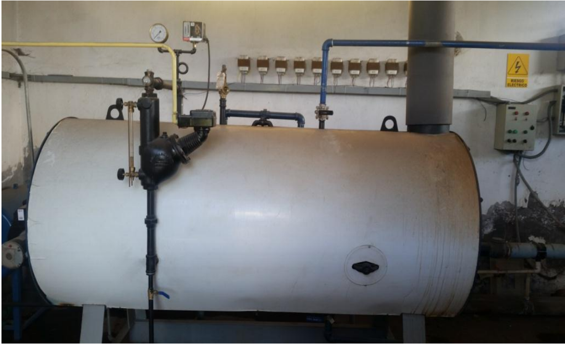
Figura 3-2. Caldera pirotubular horizontal existente Fuente: Autor
