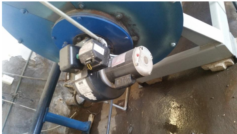
Figura 4-2. Quemador existente Fuente: Autor
