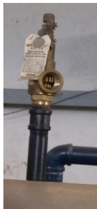
Figura 14-2. Válvula de seguridad existente Fuente: Autor
