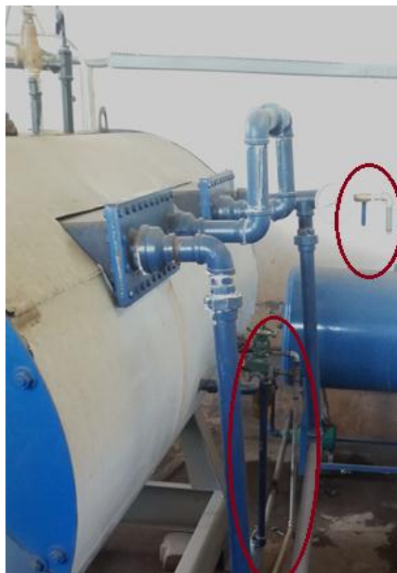
Figura 11-2. Línea de purga alta Fuente: Autor
