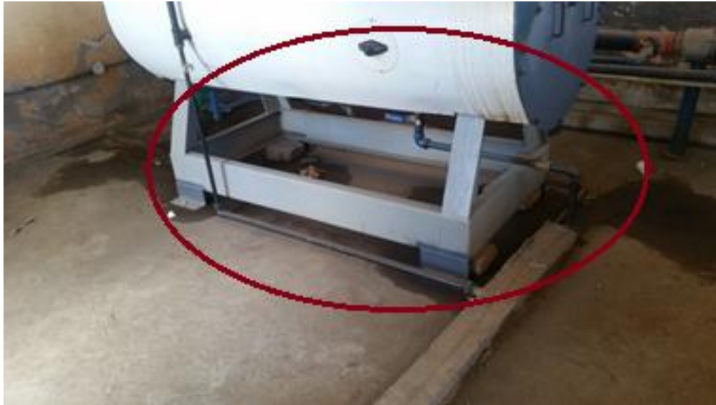
Figura 10-2. Línea de purga baja Fuente: Autor
