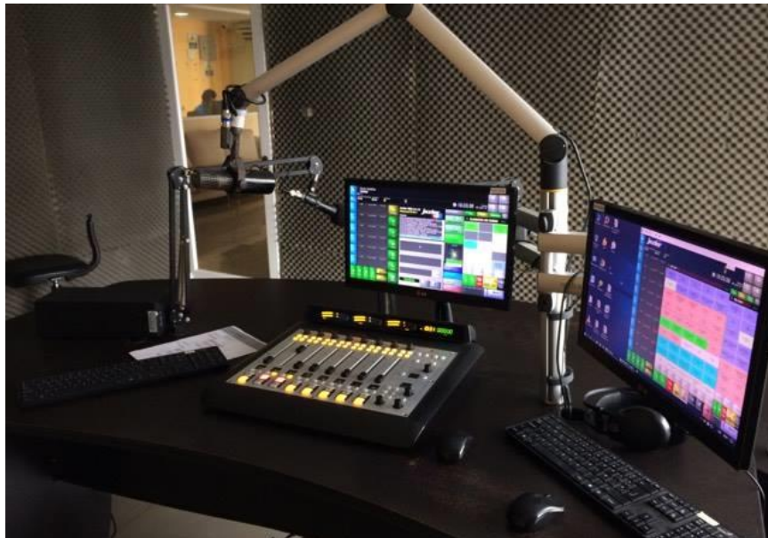
Figura 39-2 Sala de controles y locutorio de Radio Majestad
