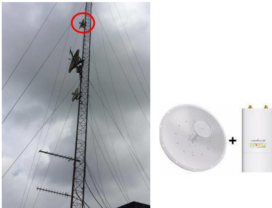
Figura 41-2 Antena y Rocket M5 ubicada a 12 m de altura en terraza.
