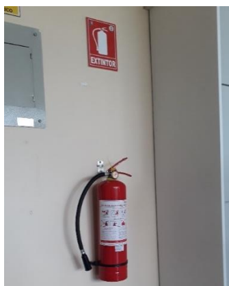
Figura 44-5: Extintor instalado en el Lab. "Calidad de Agua".
