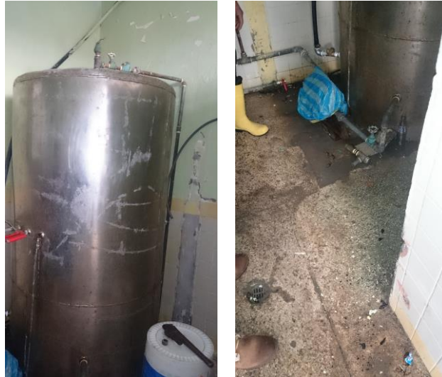
Figura 4-10. Cuarto maquina calefón duchas Fuente: Autor
