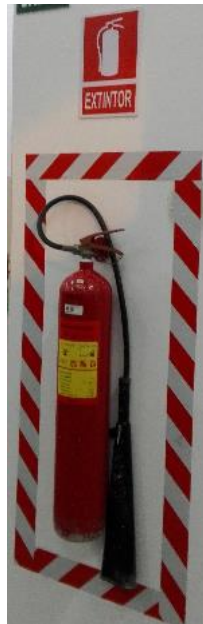
Figura 5-8. Ubicación del extintor-cuarto de máquinas Fuente: Autor
