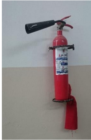
Figura 5-7. Ubicación del extintor Fuente: Autor
