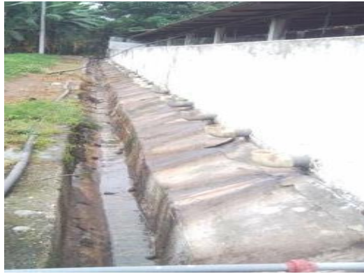
Fotografía 3-9. Separadores de decantación de excretas.
