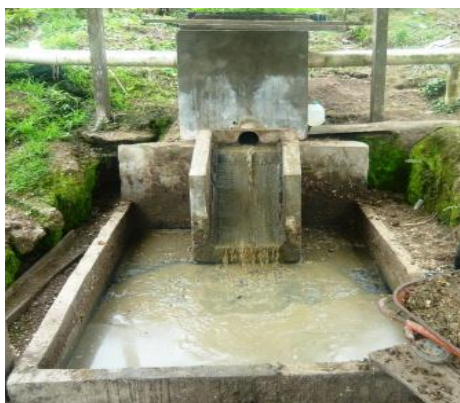
Fotografía 3-10. Separador de líquidos y sólidos.
