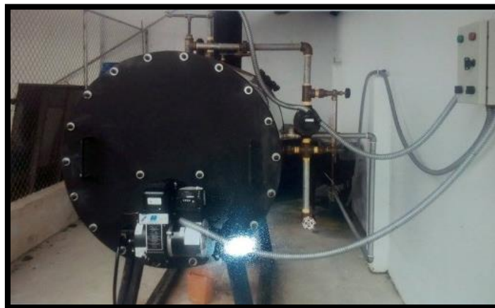
Figura 6-3 Caldero generador de vapor Fuente: Tomado de cotización de equipos ver anexo K2
