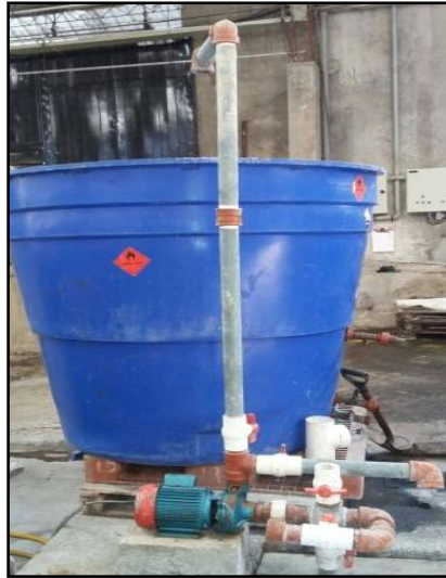
Figura 1-3: Tanque de almacenamiento
