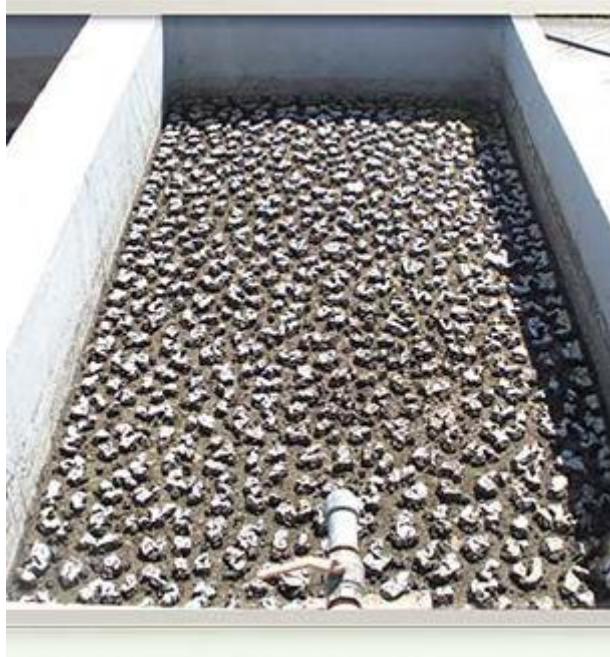
Figura 11-3 Lecho de secado de lodos
