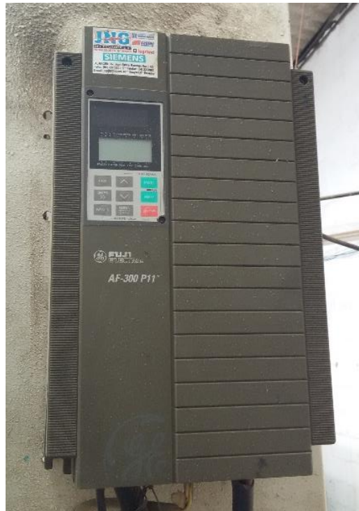
Figura 1-5 Variador de frecuencia general Fuji Electric
