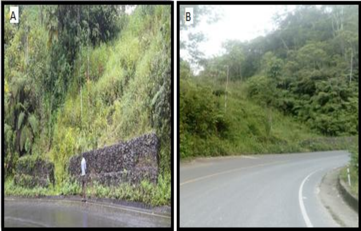
Fotografía 43-3 A) Material estabilizado con muros de gaviones B) Vista lateral . Elaborado por: Johnn Cabrera, José Solís (2017)
