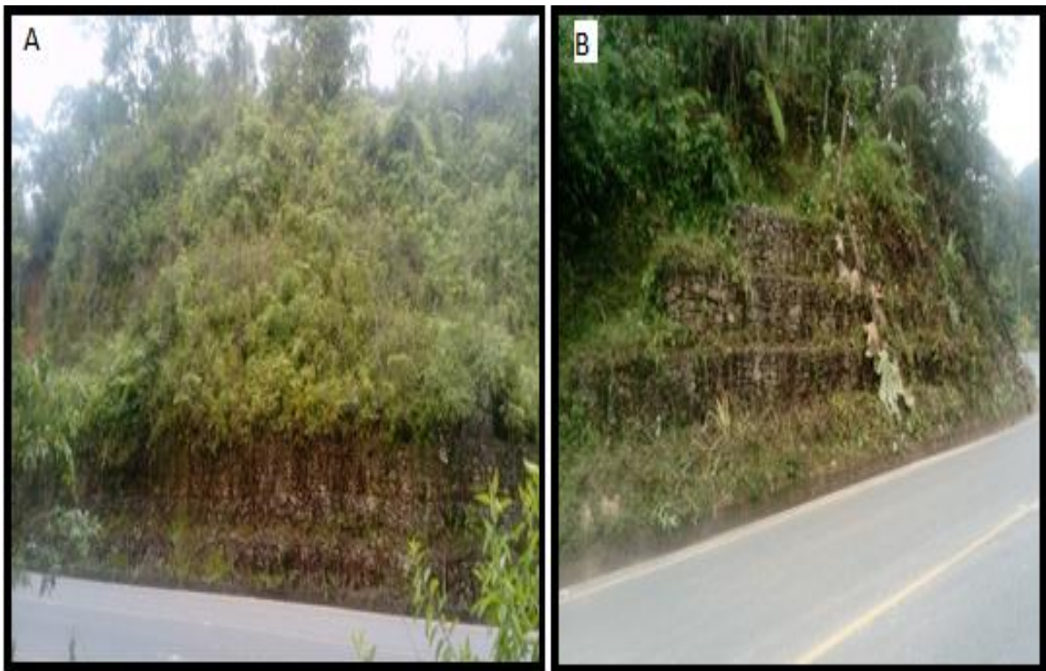
Fotografía 23-3 Deslizamiento rotacional A) Deslizamiento estabilizado con muros de gaviones B) Vista lateral del deslizamiento rotacional
