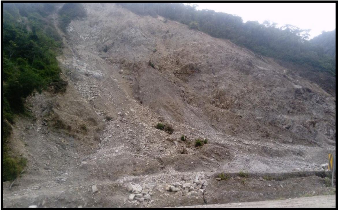
Fotografía 34-3 Deslizamiento complejo con presencia de flujos de escombros canalizado. Elaborado por: Johnn Cabrera, José Solís(2017)
