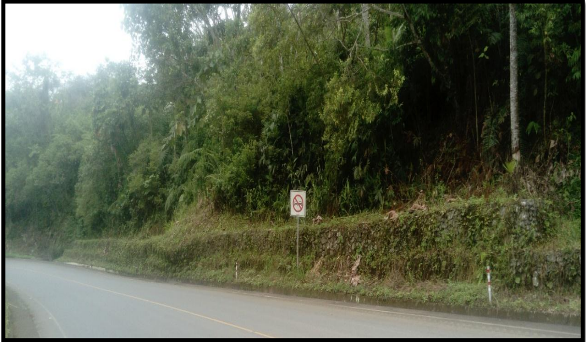
Fotografía 57-3 Deslizamiento rotacional estabilizado con muros de gaviones.
