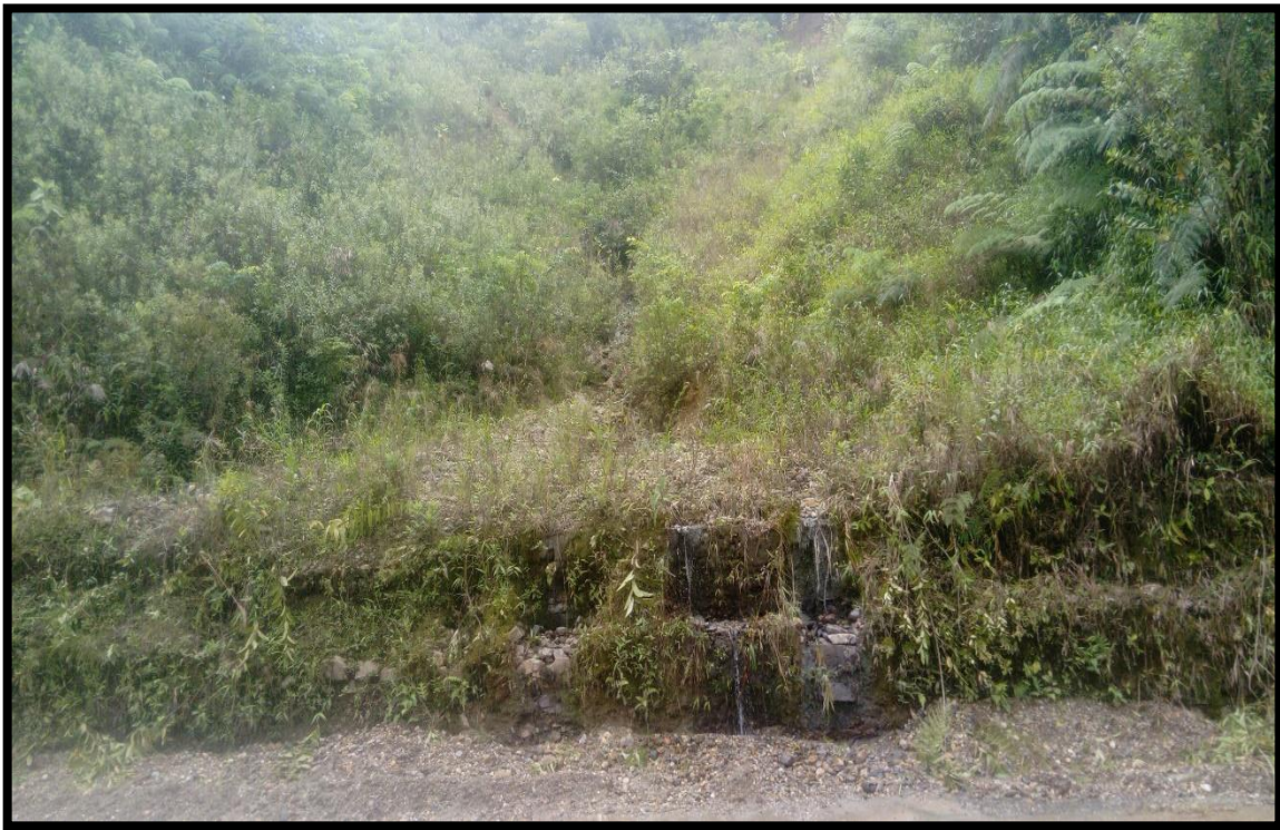
Fotografía 27-3 Deslizamiento controlado con afectación al muro de gaviones. Elaborado por: Johnn Cabrera, José Solís (2017)
