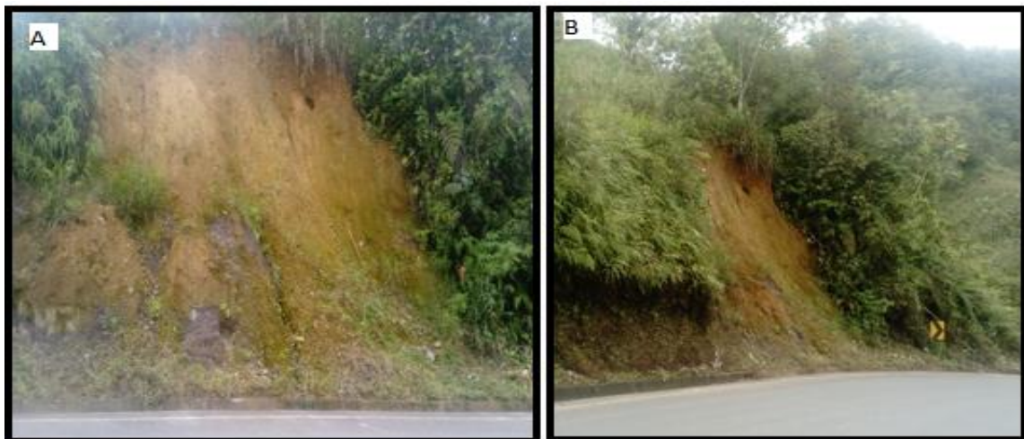
Fotografía 20-3 Deslizamiento rotacional A) Roca intrusiva meteorizada B) Vista lateral del deslizamiento.
