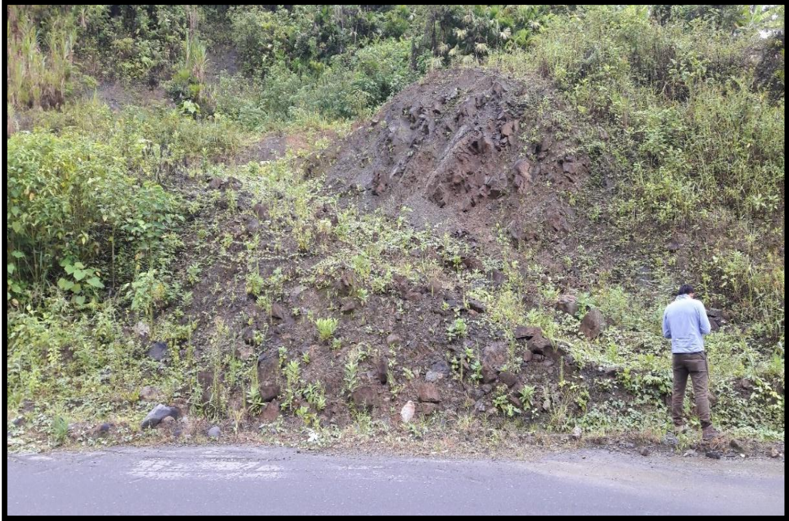
Fotografía 55-3 Deslizamiento de tipo rotacional con presencia de cuarcita altamente fracturada. Elaborado por: Johnn Cabrera, José Solís (2017)
