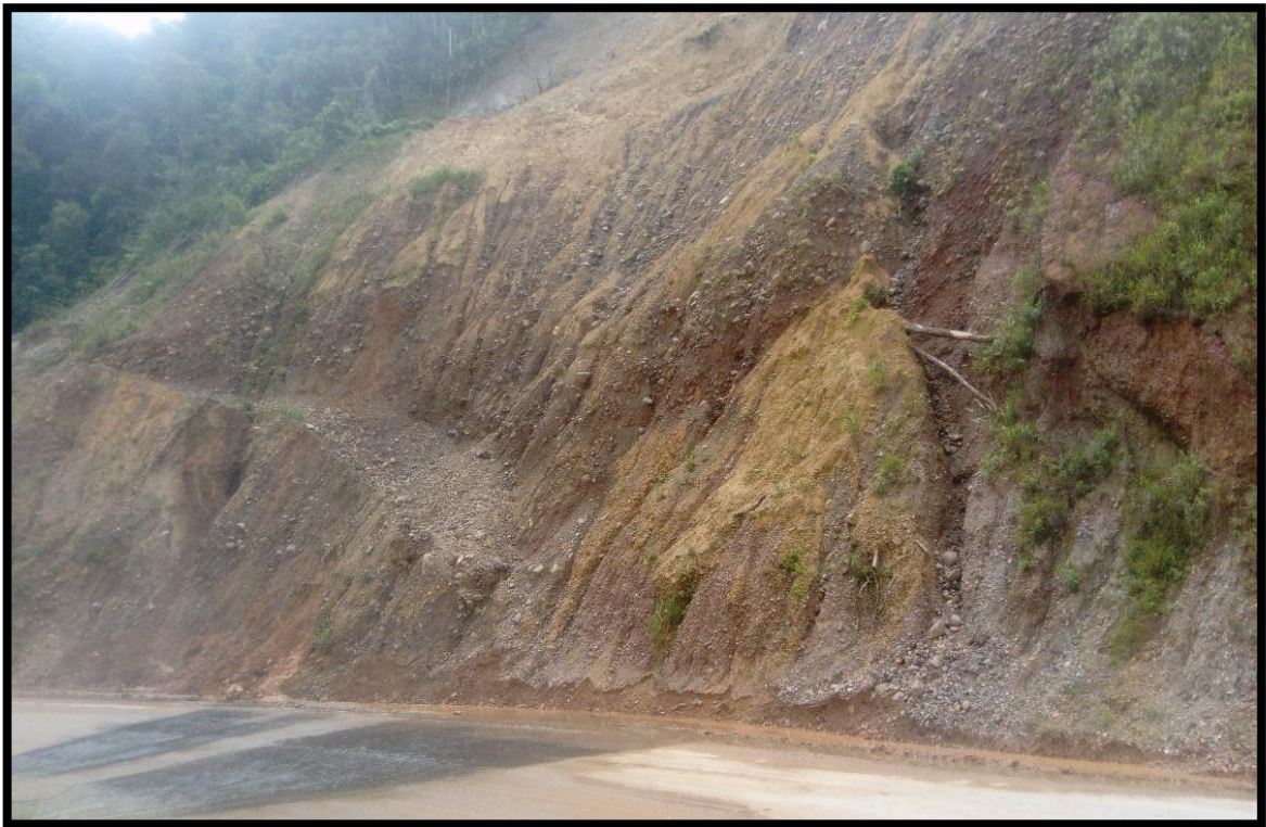
Fotografía 31-3 Deslizamiento con presencia de oxidaciones de hierro y suelo arcilloso de color amarillento.
