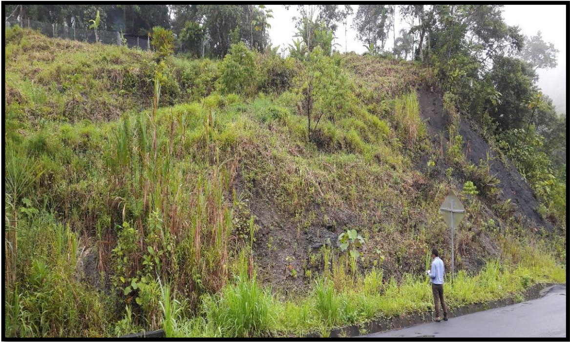
Fotografía 53-3 Deslizamiento rotacional se observa un contacto entre caliza y material aluvial. Elaborado por: Johnn Cabrera, José Solís (2017)
