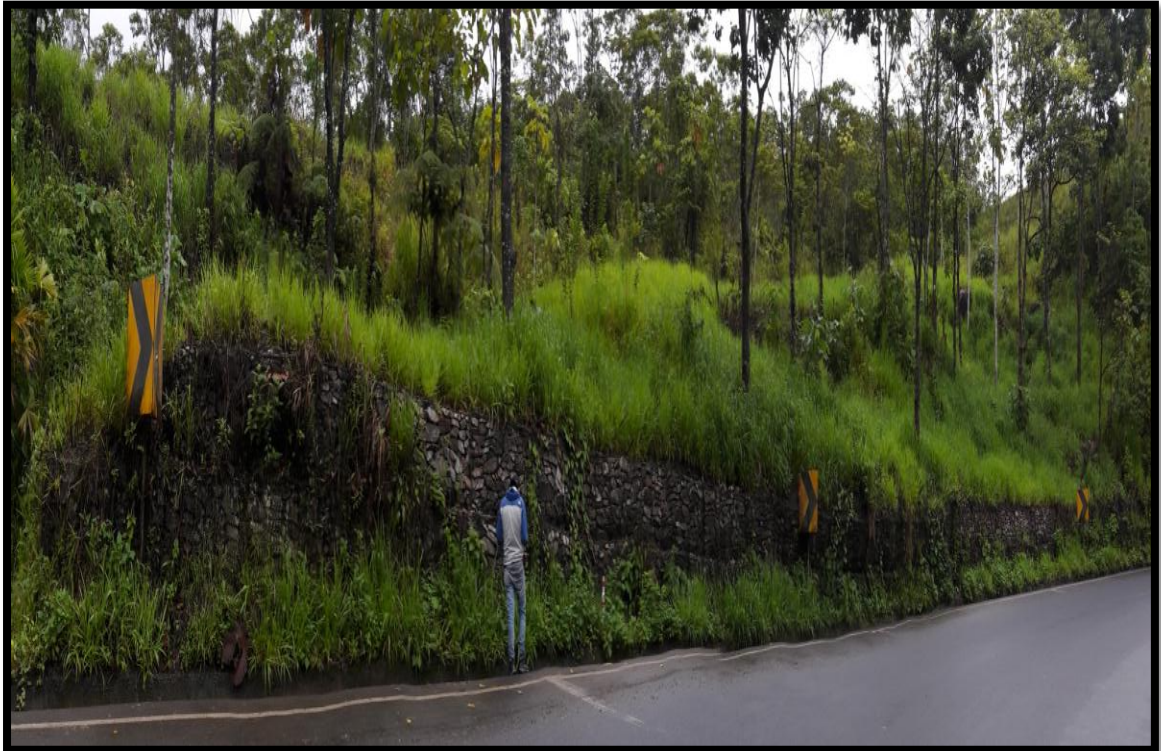
Fotografía 51-3 Flujo de escombros se encuentra estabilizado con muros de gaviones. Elaborado por: Johnn Cabrera, José Solís (2017)
