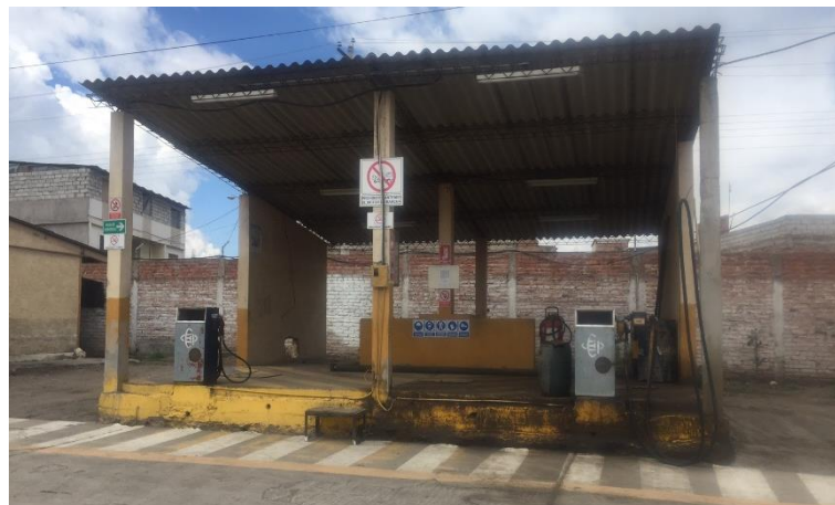
Figura 3-4. Área de despacho de combustibles.
