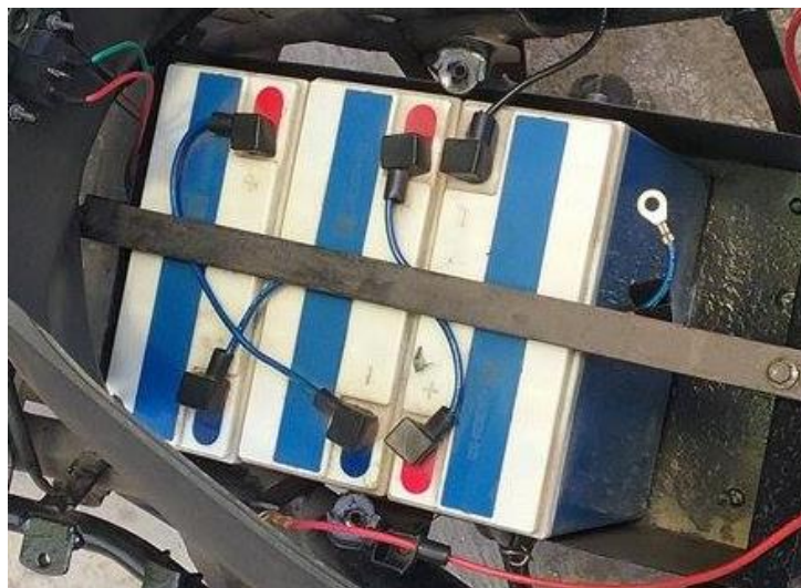
Figura 10-3: Conexión de Batería en serie Fuente: Autores
