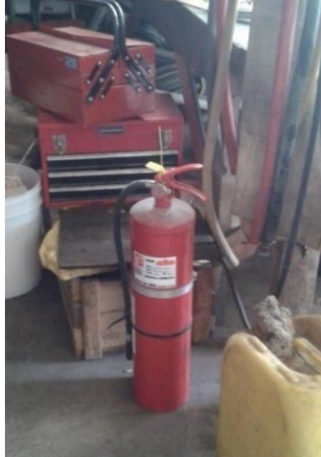
Figura. 4-5: Extintor sin mantenimiento en el piso
