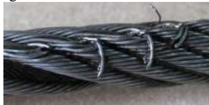
Figura 13-4. Alambre en mal estado
