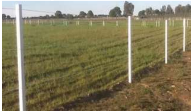
Figura 5-2. Postes de madera
