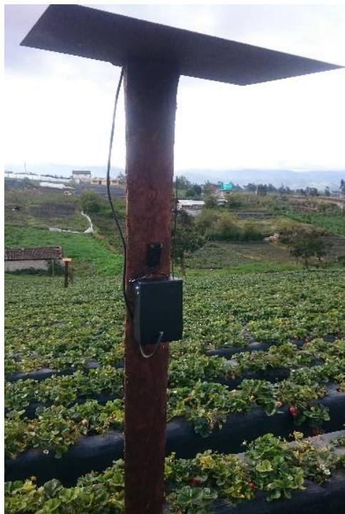
Figura 10-3: Instalación módulo de Supervisión Ambiente 1 Realizado por: ARCOS, Daniel. 2017
