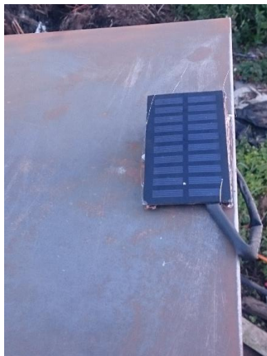
Figura 13-3 Instalación panel solar Realizado por: ARCOS, Daniel. 2017
