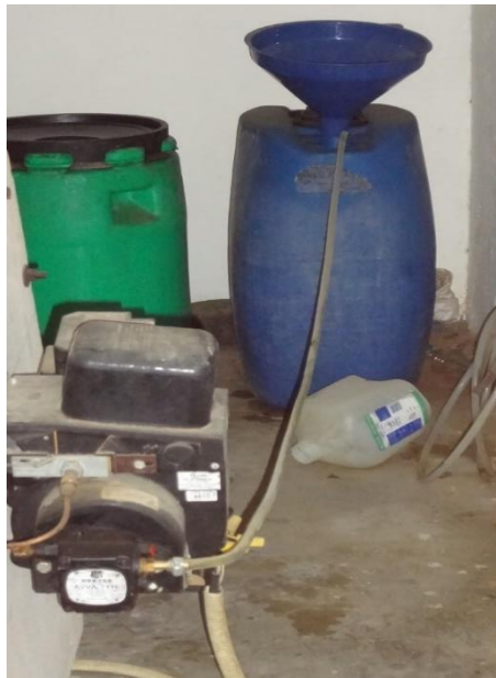
Figura N°. 38 Riesgo de Explosiones
