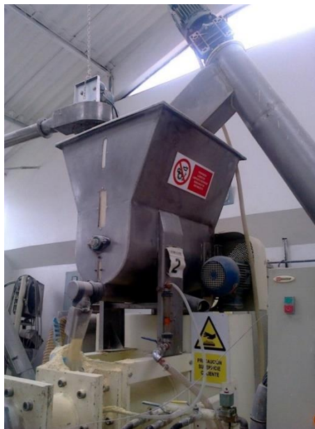
Figura N°. 37 Superficies con Altas Temperaturas
