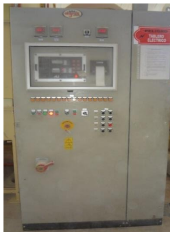
Figura N°. 26 Estado Actual de Tableros Eléctricos Internos
