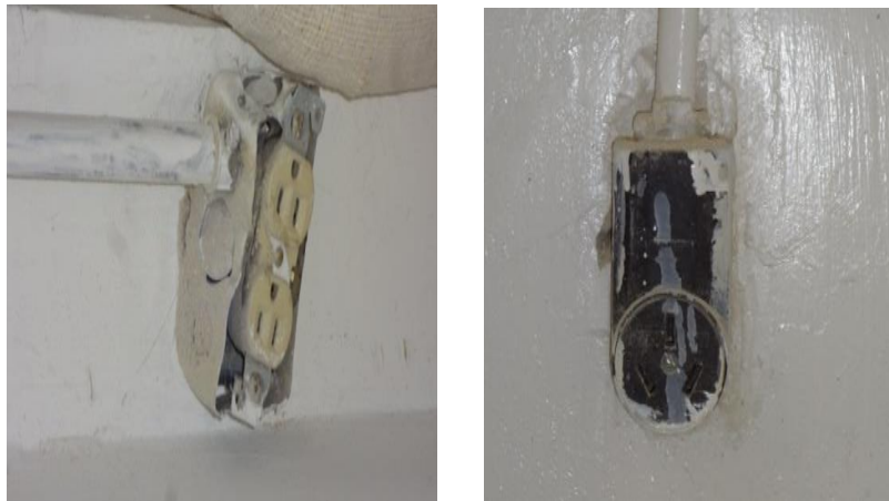
Figura N°. 27 Estado Actual de los Toma Corrientes
