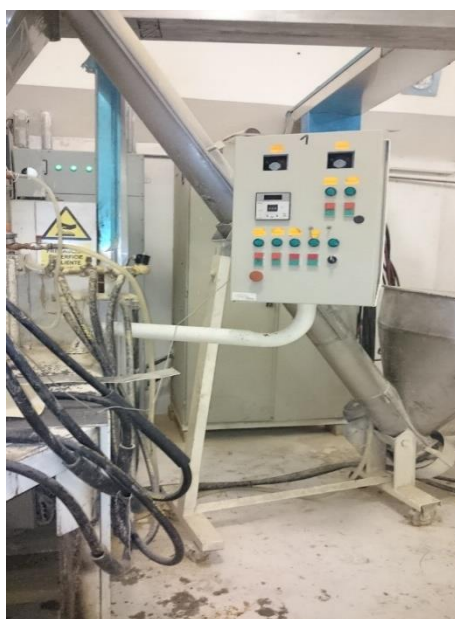
Figura N°. 41 Tableros Eléctricos de Mando Nuevos.
