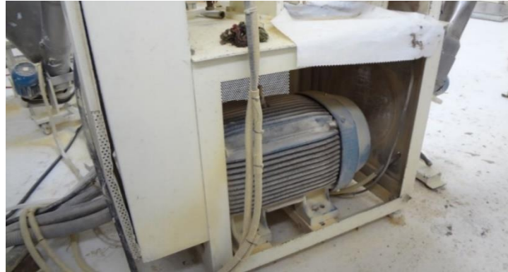
Figura N°. 32 Protecciones para los Motores
