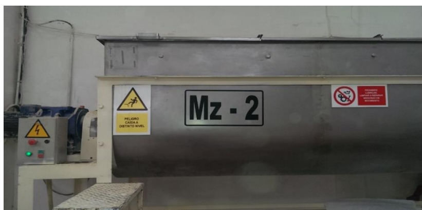
Figura N°. 67 Señales de Prevención del Área de Mezclado
