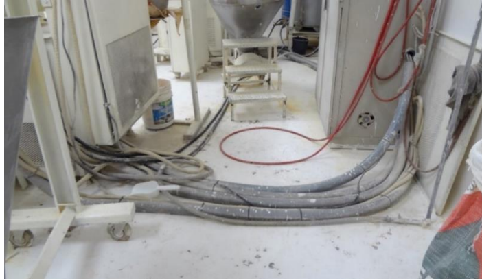
Figura N°. 29 Estado Actual de los Cables Eléctricos
