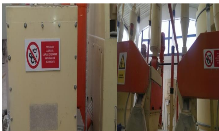
Figura N°. 57 Señales de Prohibición del Área de Molino Agrex
