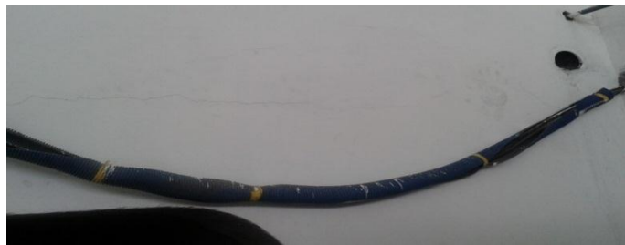
Figura 21. Alimentación tablero principal cuarto de máquinas
