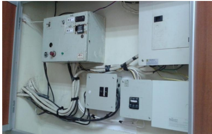
Figura 33. Control oficina de administración (Aplicado mantenimiento)
