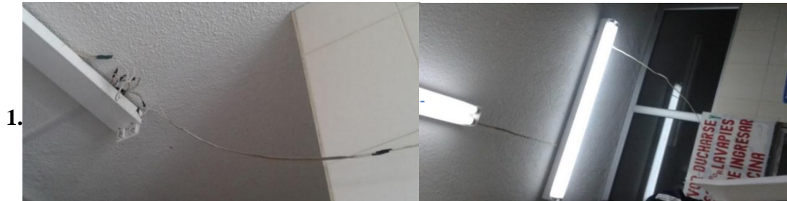
Figura 6. Luminaria entrada principal
