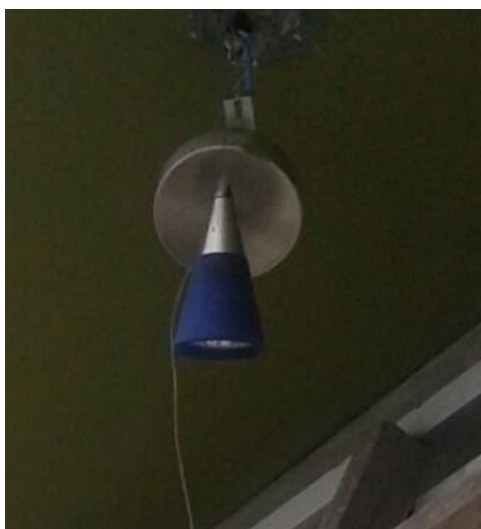
Figura 5. Luminaria frontis de la piscina
