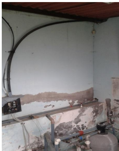
Figura 27. Alimentación generador de vapor
