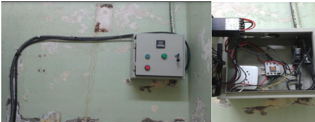
Figura 34. Calentamiento duchas (Aplicado mantenimiento)
