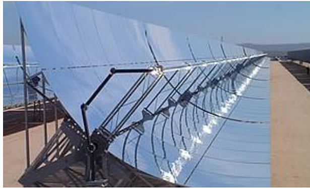
Figura 8-2.- Concentrador solar cilíndrico parabólico
