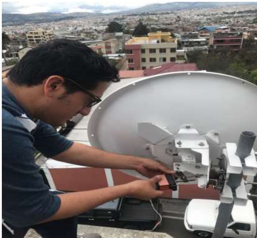
Figura 65-3: Implementación del Transmisor en la parroquia de Pinllo (A)
