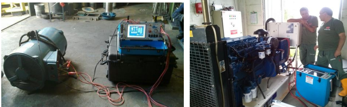
Figura 19-4: Mantenimiento Predictivo Pruebas Off -Line
