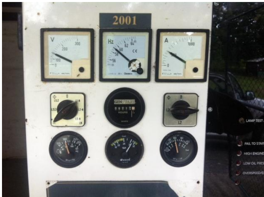
Verificación de parámetro de generador
