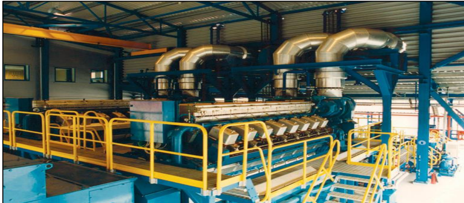
Figura 8-2. Grupos electrógenos de la central de generación Secoya
