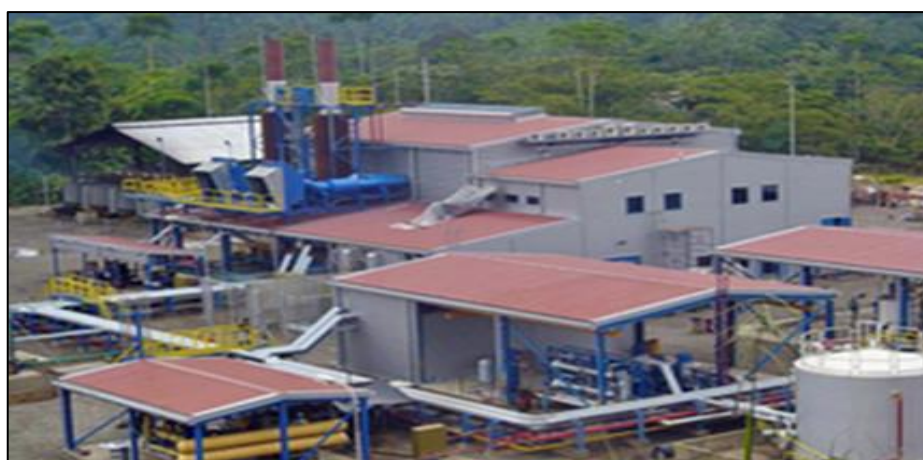
Figura 5-2: Central de generación Secoya
