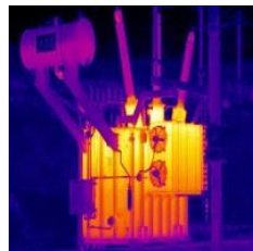
Figura 4-2. Termografía de transformador elevador 480 VAC a 13,8 kV
