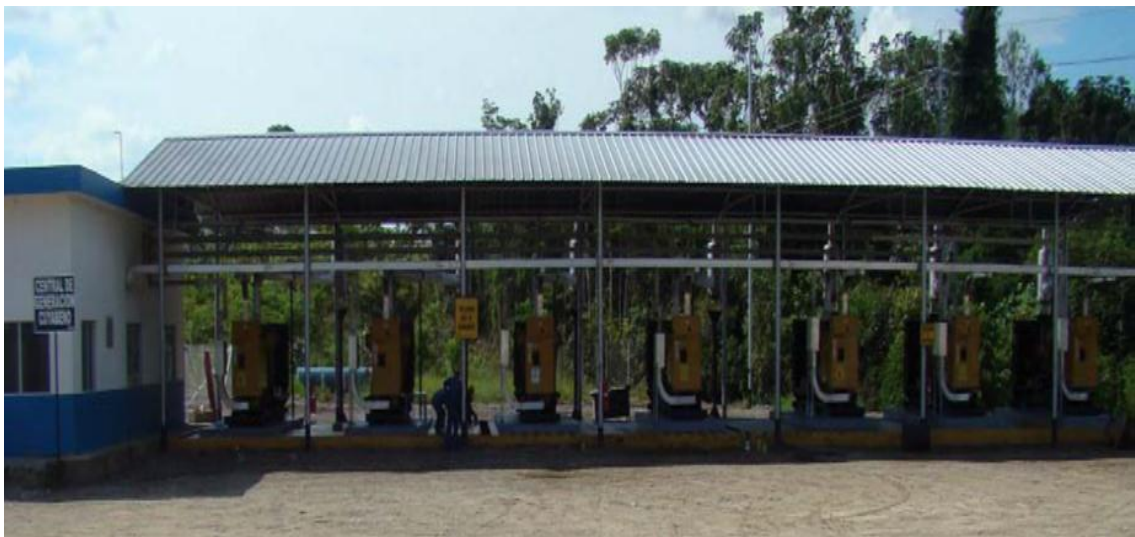
Figura 1-3. Central de Generación Cuyabeno 4,4 MW
