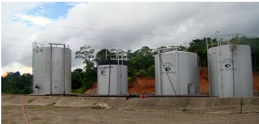
Figura 4-4. Tanques de almacenamiento de combustible Central de generación Cuyabeno
