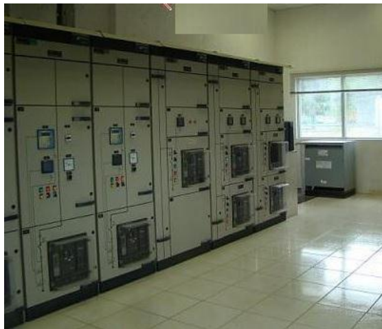
Figura 4-6. Panel principal del Sistema de control de la central de generación Cuyabeno
