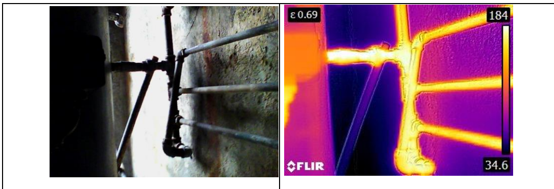
Figura 67. Análisis termográfico, red de tuberías
