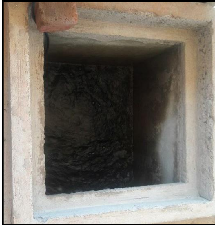
Figura 2-2: Tanque de Captación
