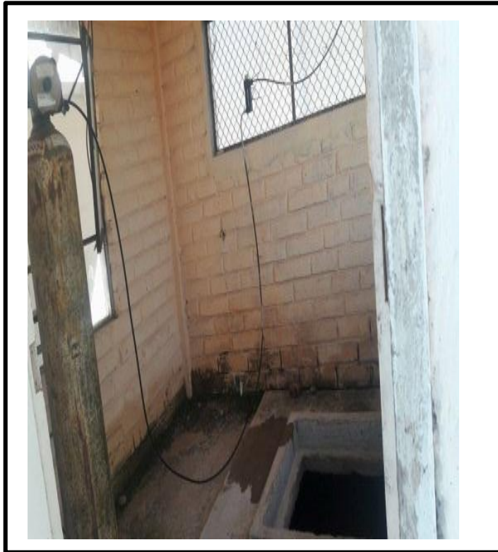
Figura 5-2: Tanque de Cloración
