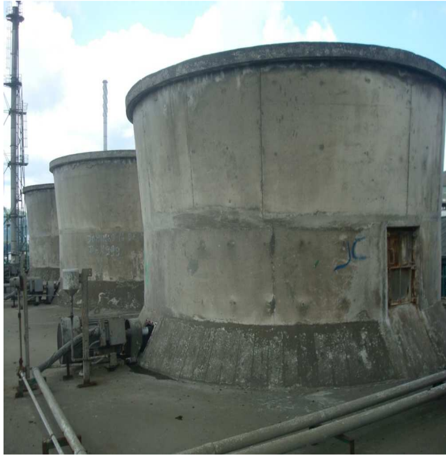
FOTO 2.3.1-2.Chimenea - motor de la celda “d” de la Torre Y-ME3003B de la REE
