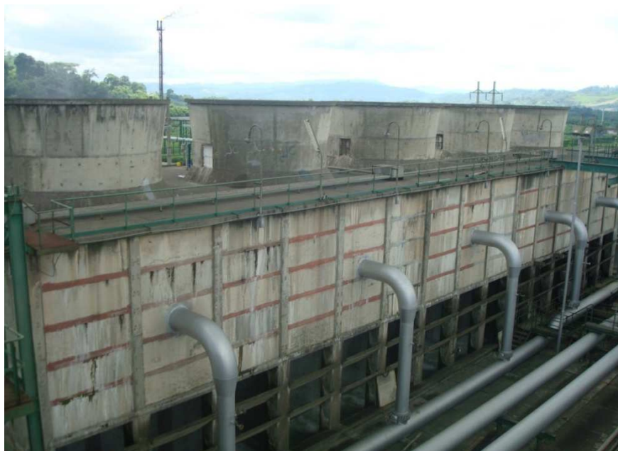
FOTO 1.3-1. Sistema de Enfriamiento-Torre Y-ME3003B DE LA REE
