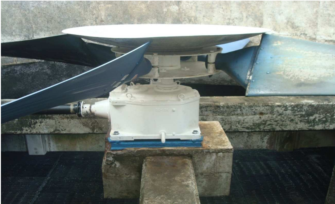
FOTO 2.3.1-3. Ventilador de la celda “d” Torre Y-ME3003B de la REE
